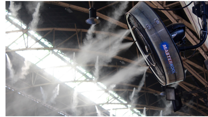
Figuur 10. Waterbevochtiging direct in de ruimte. Worp wordt door gebruik van ventilator vergroot.
